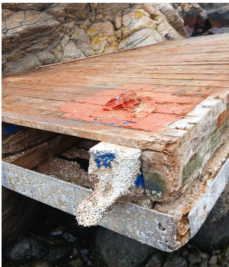
Figur 27: En uppspolad flytbrygga med trä på ovansida och undersida samt söndrig cellplast emellan. Orust. Foto: Västkuststiftelsens arkiv.
