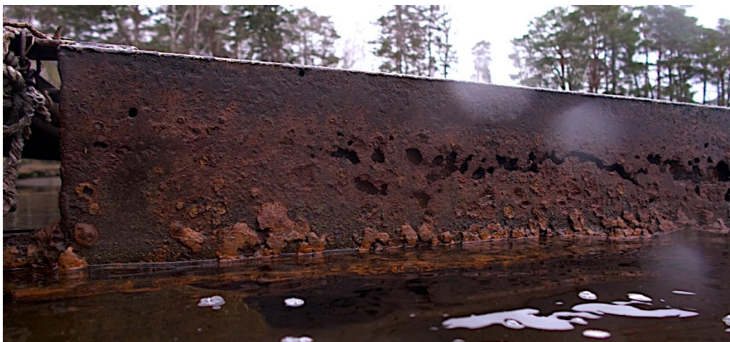
Figur 22: Sidan av en flytbrygga som är delvis infattad i betong som börjat vittra. Delsjön. Foto: Havsmiljöinstitutet.
