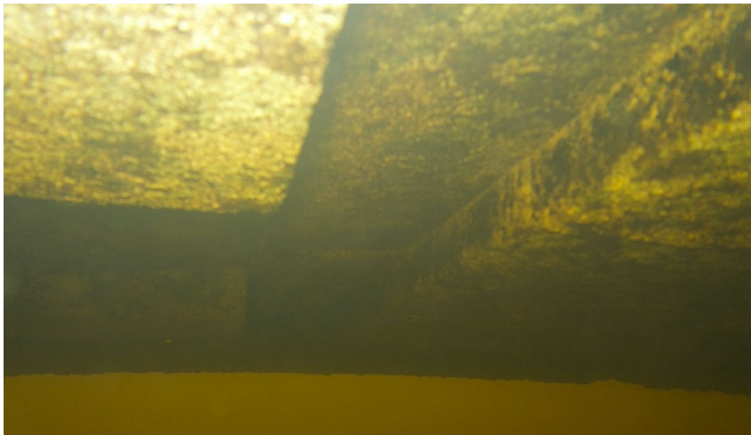
Figur 23: Undersidan av en delvis betonginfattad flytbrygga med blottlagd cellplast på undersidan. Delsjön. Foto: Havsmiljöinstitutet.
